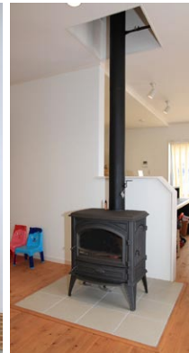
堂々たる風格の薪ストーブ。太い煙突が天井を突き抜けて外へ伸びています
